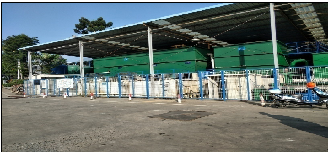
制造六、八厂区事故应急池建成照片
