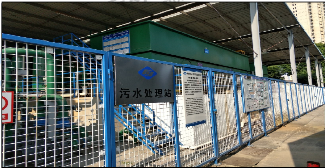
玻璃污水回用处理站
