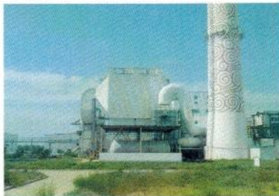
脱硝除尘设施
