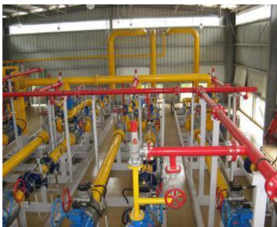
天然气调压站
