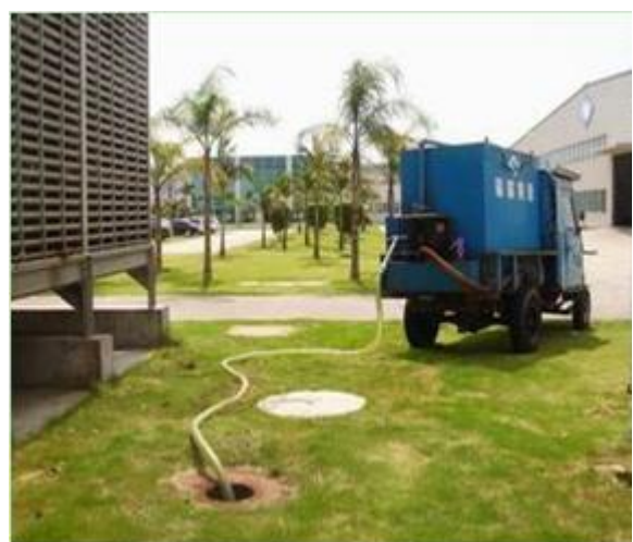
厂区生活污水汲取
