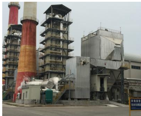
脱硝除尘设施、余热发电锅炉
