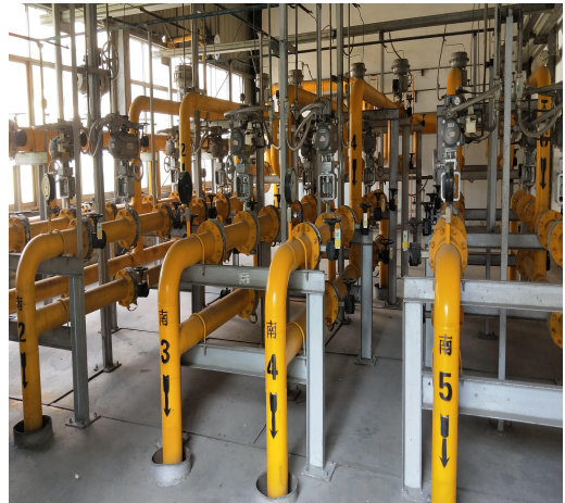
天然气调压站
