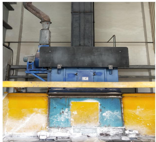
上料口除尘设施
