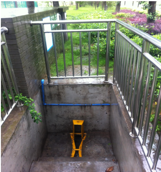
生活污水排放口
