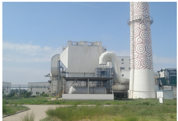
脱硝除尘设施
