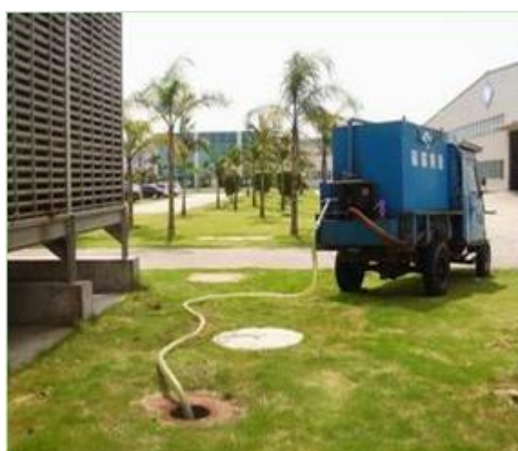
厂区生活污水汲取
