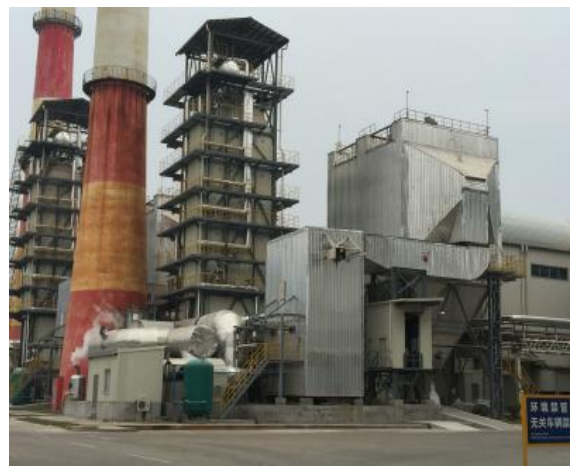
脱硝除尘设施、余热发电锅炉
