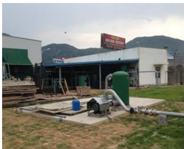
循环水废水沉淀池
