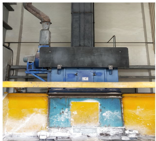
上料口除尘设施
