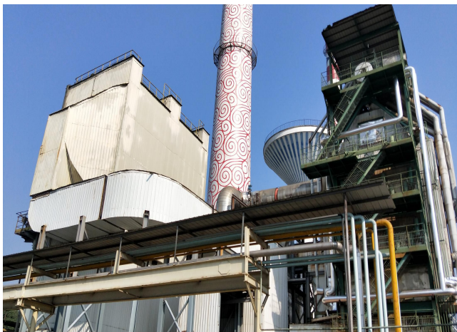
除尘脱硝系统
