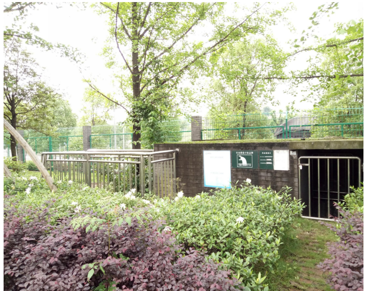
生活污水处理装置
