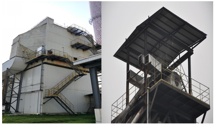
脱硝设施密封除尘降噪及消声器
