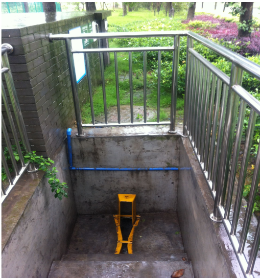
生活污水排放口
