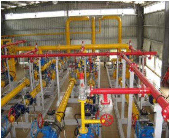
天然气调压站
