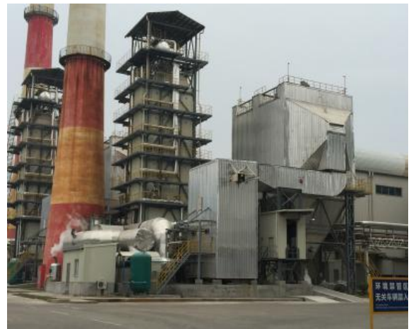
脱硝除尘设施、余热发电锅炉
