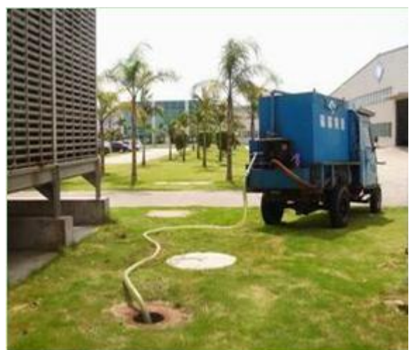
厂区生活污水汲取
